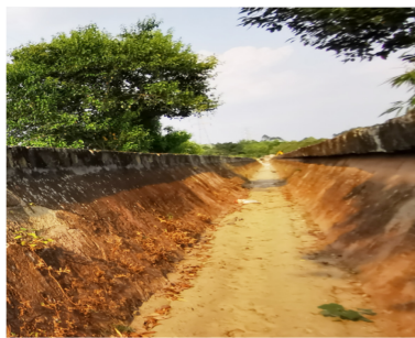
图 4 槽身底板整体淤积严重
