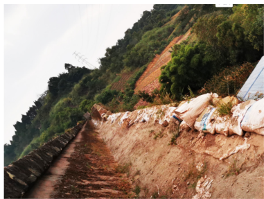
图 3 毛家河渡槽左边墙中间段整体垮塌
