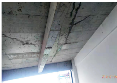
图3 支撑不足导致裂缝
