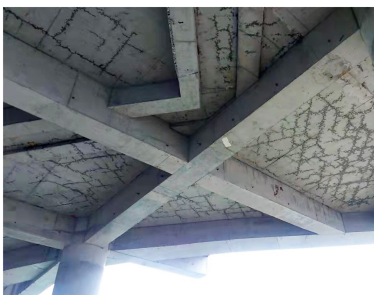
图4 钢筋垫块缺失导致裂缝
