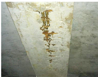
图 1 结构钢筋锈蚀
