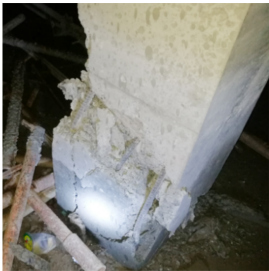
图 5 典型柱破坏情况
