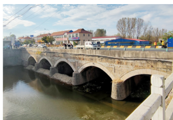
图 1 石拱桥现状照片
