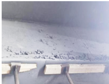
图 3 混凝土梁局部蜂窝现象
