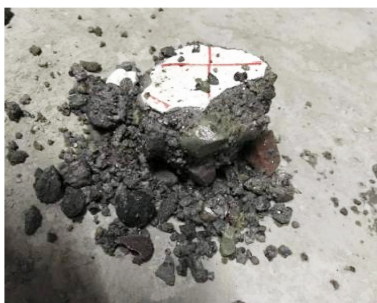
图 5 压溃柱检测区域 2 混凝土严重离析现象
