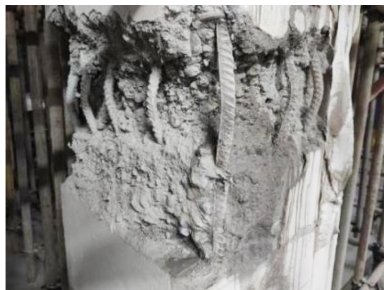
图 4 压溃柱中下部混凝土压溃及纵筋压屈
