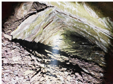
图 2 突涌后现场情况
