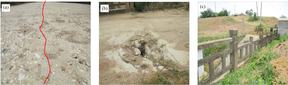
(a) 桥面纵向裂缝；(b) 桥面铺装破损；(c) 桥面护栏缺损
